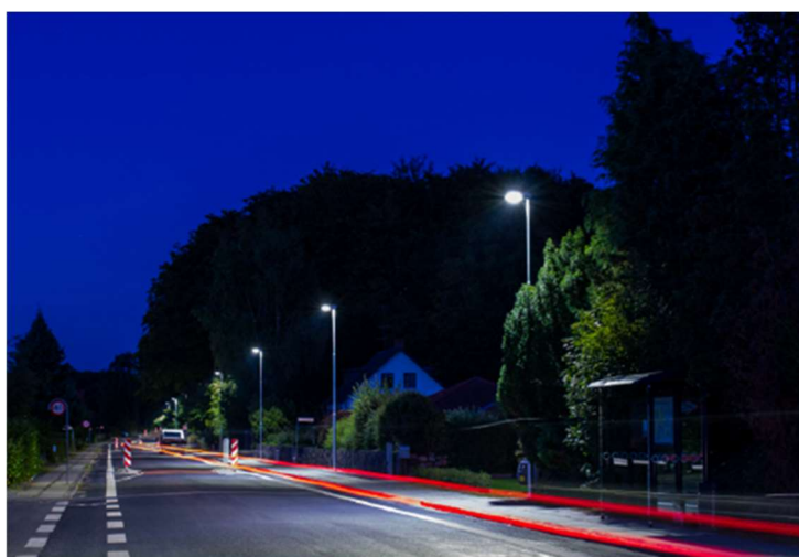
Kogtvedvej med ny LED belysning
