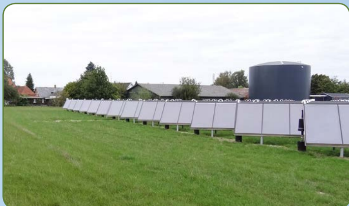
Solfangeranlæg ved Skårup Fjernvarme.
