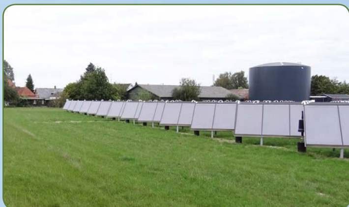
Solfangeranlæg ved Skårup Fjernvarme.
