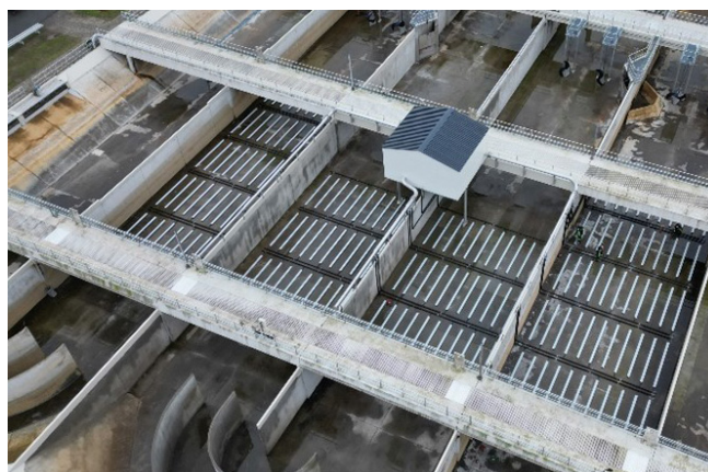
Nye beluftningsfelter monteret på bunden af tankene. Blæserhus ses i midten.
