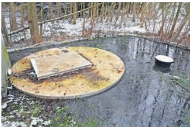
Kloakvandet siver stille og roligt ud af brønden og havner i den nærliggende Lillebæk ved Oure. Foto: Andrea Bisgaard
