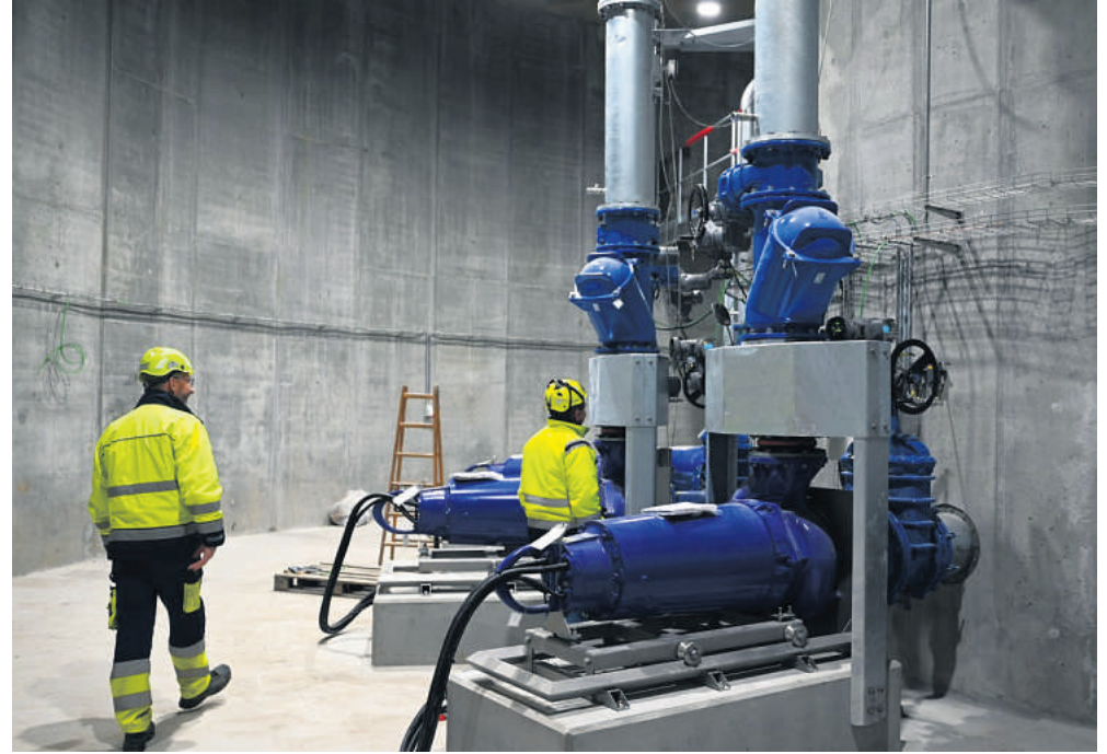
I modsætning til den gamle pumpestation, er der god plads i den nye pumpestation på havnen i Svendborg. Foto: Anders Røjgaard Fly
