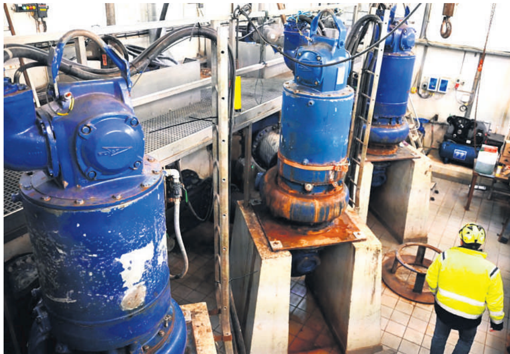
Der er ikke meget plads i den gamle pumpestation på kajen i Svendborg. Foto: Anders Røjgaard Fly
